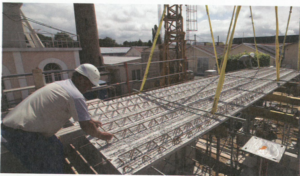
Pour le plancher de l'étage, Rector a fabriqué des prédalles, une innovation permettant de réaliser des architectures complexes.
